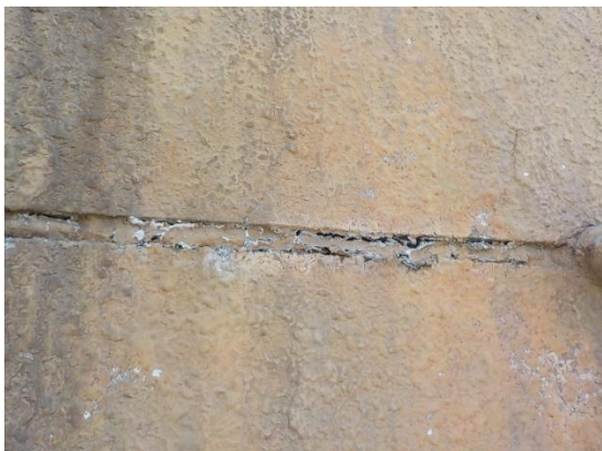
シーリング 腐食状況
